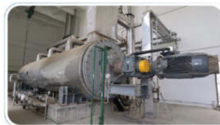
● 成都市第一城市污水污泥处理厂 二期工程
