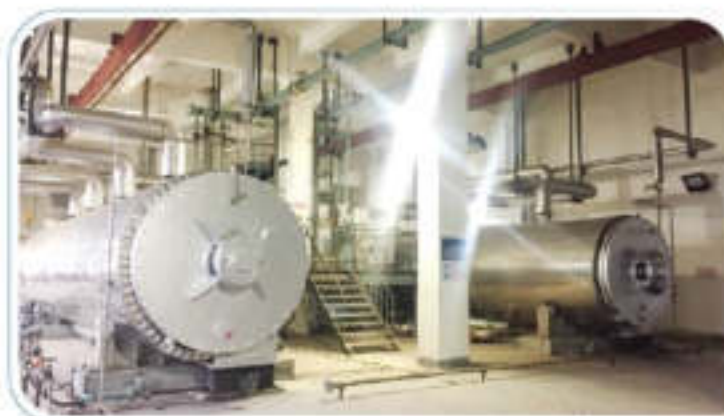
● 成都市第一城市污水污泥处理厂 一期工程
